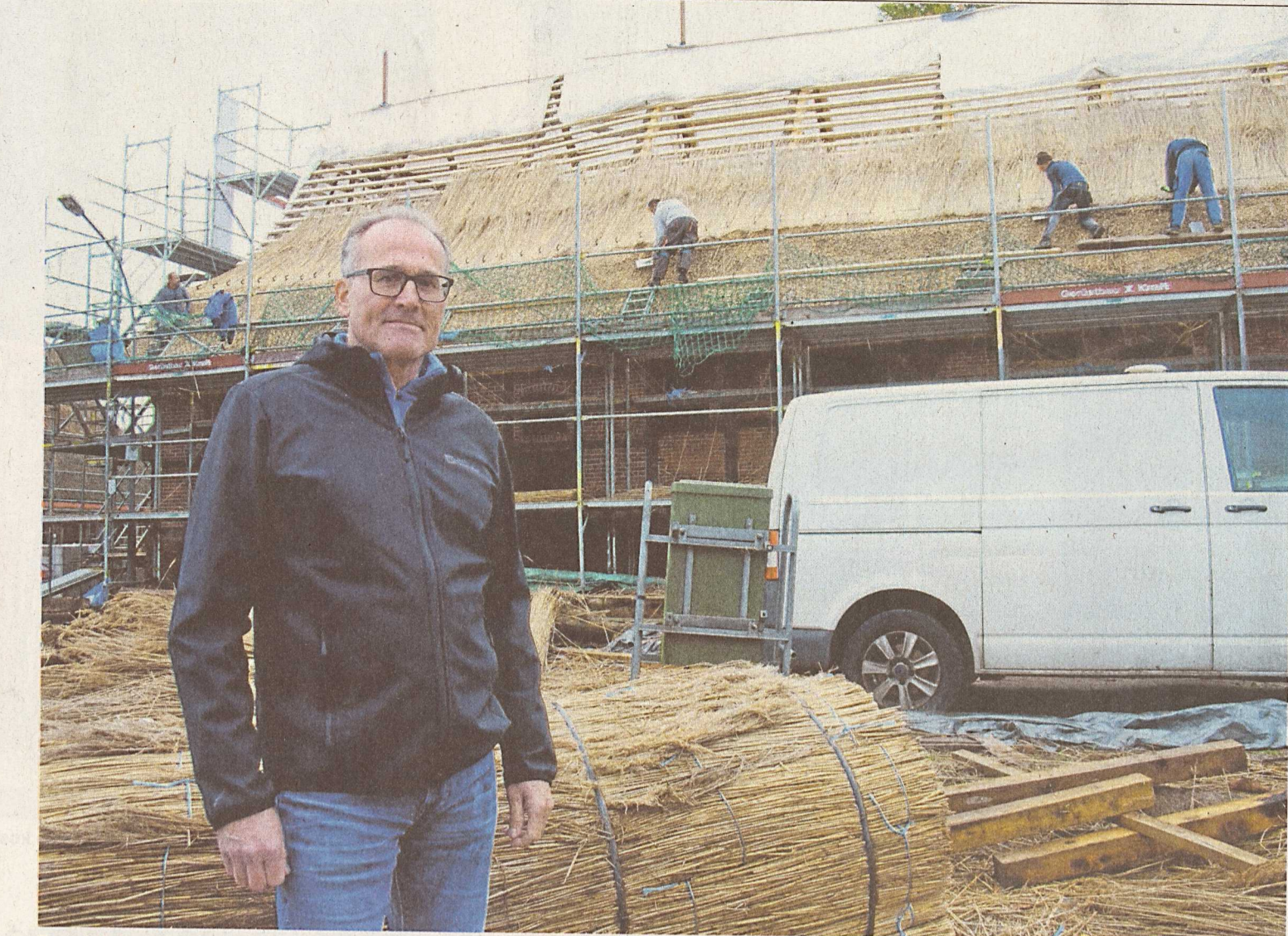
Projektleiter Jörg Ruschmeyer von der Firma May & Co. vor der früheren Scheune, in die eine Bäckerei einziehen wird.
